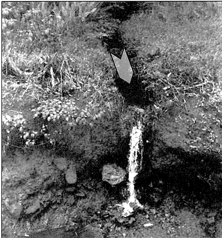
Photo 8. Puolua (Huelo) at New Hamakua Ditch (NH-17a).
